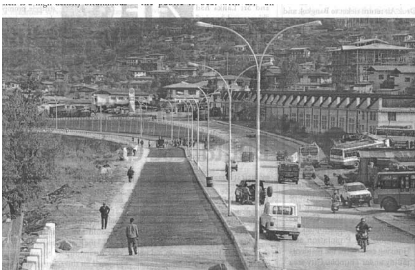
Das erste Teilstück der Autostraße nach Phuentsholing in Babesa bei Thimphu ist fast fertig. Photo: Kuensel
