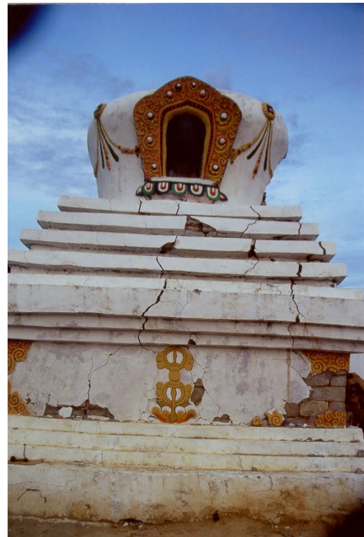
Von großen Tschörten ist nicht nur die Spitze abgebrochen. Auch der Untere Teil des Tschörtens ist soweit zerstört, dass er nicht mehr repariert werden kann. Foto: M. Gerner
